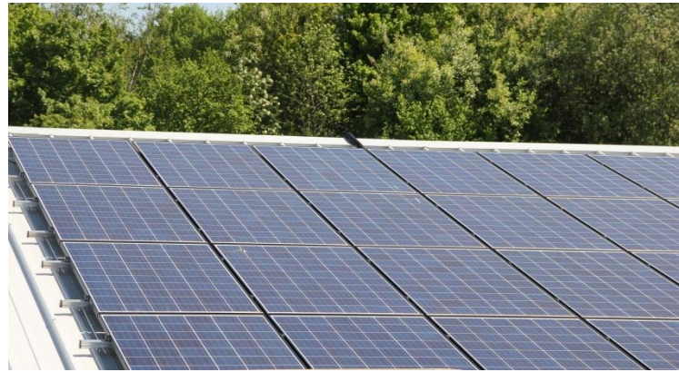
Bild 7: Solaranlage auf dem Hallendach
